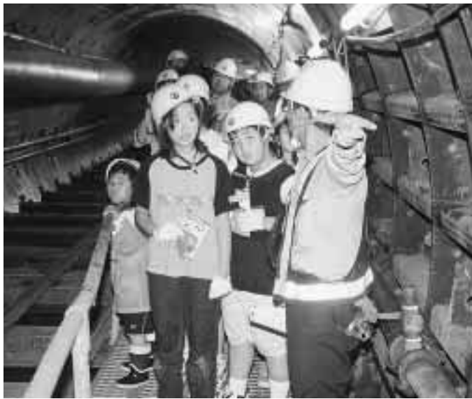
小針小4年生を対象にした坂井輪雨水幹線の工事見学会
