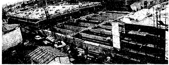
左側が放気槽(好気性細菌で汚物を処理)中央が最終沈殿池、右の高い部分が、減圧池です。
