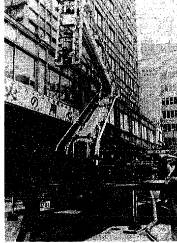
先端の上下左右に動くノズルから放水します
