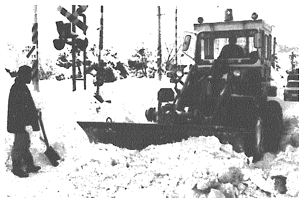
▲久しぶりの晴れ間に県道白根・間瀬線の和納踏切を一斉排雪——幅員10メートルの車道は2メートルを超す雪の壁で5メートルほどに縮まっている。
