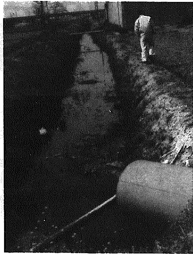
汚れが進む山田排水路
