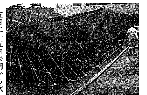
▲倒壊したビニールハウス
