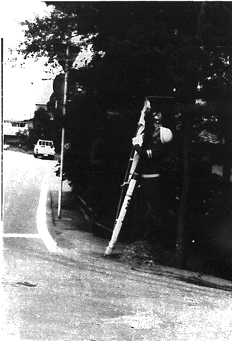
見まわり途中、交通安全を願って立てた旗が破損。ただちに修理屋さんに早変わり
