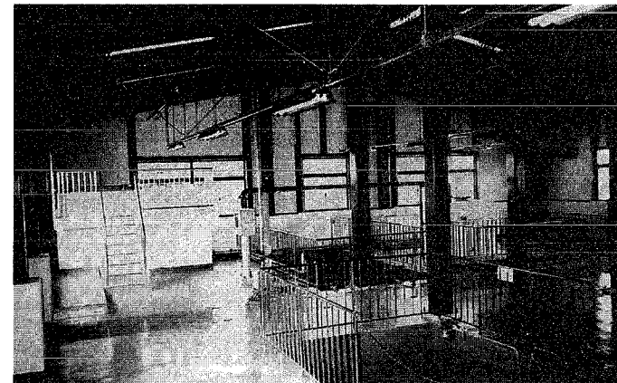
着水井・高速凝集沈殿池・急速ろ過池
